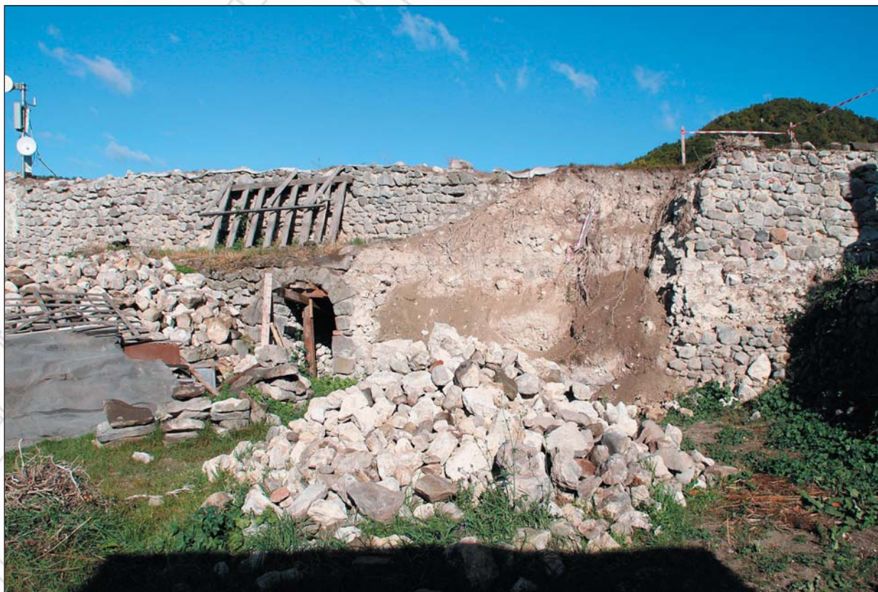
Obr. 2 Stav pred začatím prác - zrútenie muriva a takmer celého schodiska - havarijný stav
