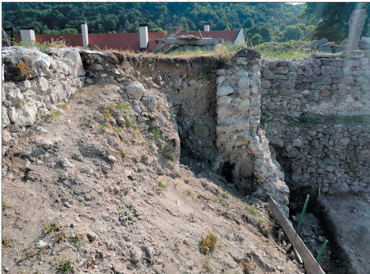
Obr. 11 Profil zrútených častí pred začatím prác. Sú viditeľné závažné statické poruchy - odtrh sekundárnej plenty, veľké kamenné segmenty v nestabilnej sypanine
